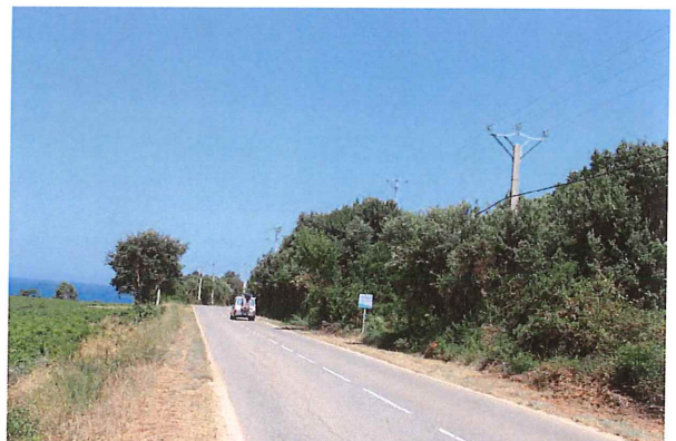
Le réseau électrique
