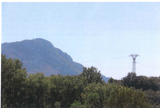
Le réseau électrique sur les reliefs
